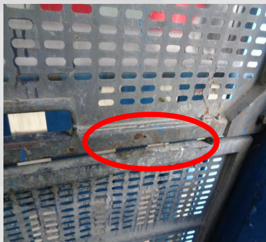
施工升降梯门机械门联 锁未安装
