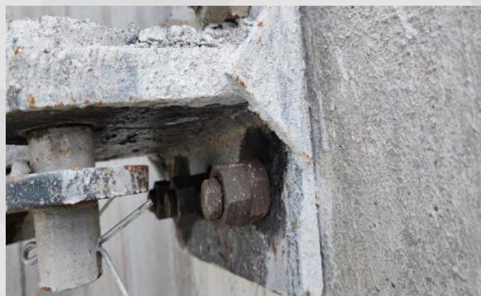
塔吊附墙垫块厚度不足，且耳板、抱框螺栓露丝不足三丝
