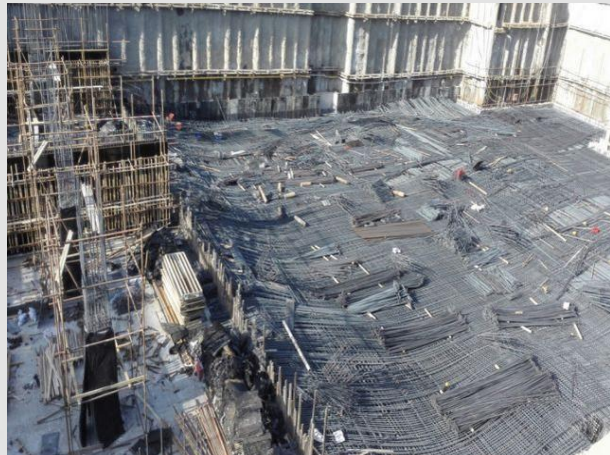
底板钢筋上集中堆放物料，致使支撑体系无法承受堆料荷载而塌陷
