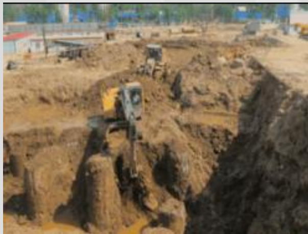
挖机上下垂直作业未设置防护措施
