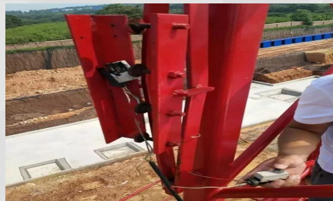
力矩限制器没有接通且损坏
