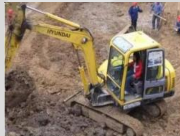
挖机作业时回旋半径范围内存在施工人员
