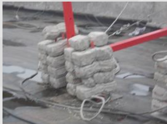
配重块未从配重支管穿入， 配重块破损
