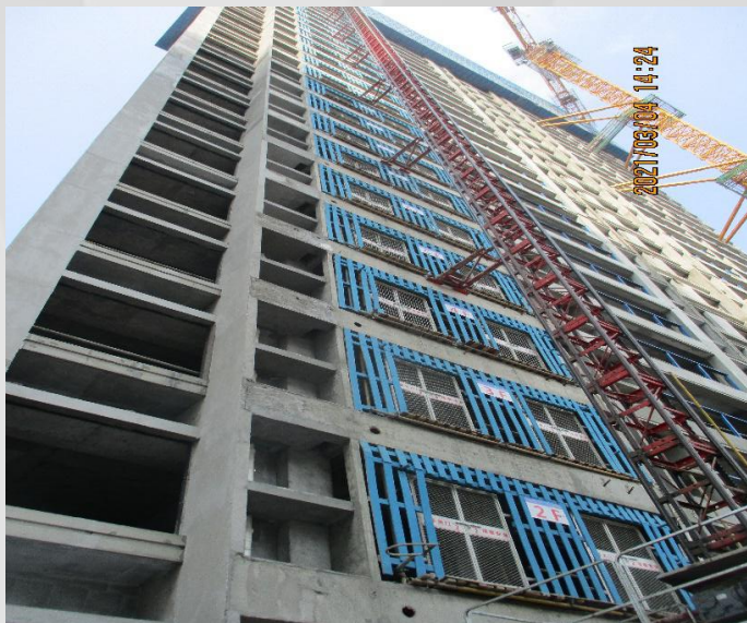
电缆导向架未按使用说明书设置
