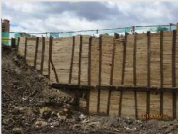
钢板桩倾斜、变形、 间距不均匀
