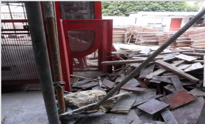
施工升降梯基础周边存在较多垃圾，不方便检查
