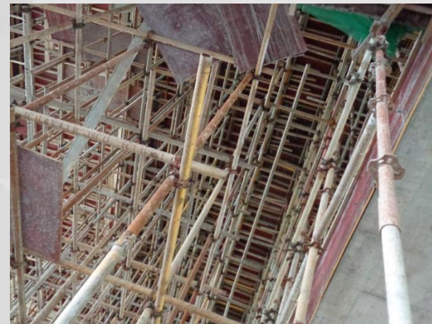
高支模水平横杆未连通设置
