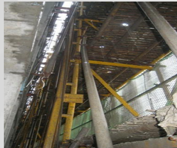
竖向桁架缺少必要的支承
