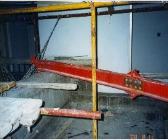
悬挂支架存在明显变形
