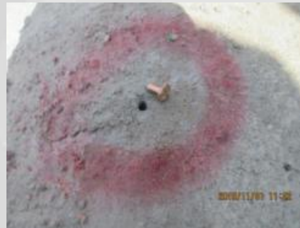
基坑监测点埋设深度不足，可徒手拔除
