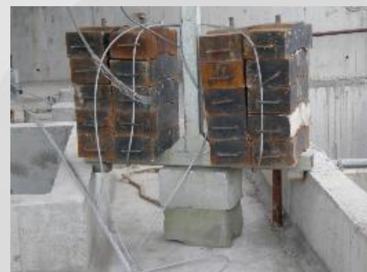
悬挂机构后座支架支撑 点稳定性差
