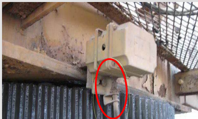
塔吊回转限位缺失
