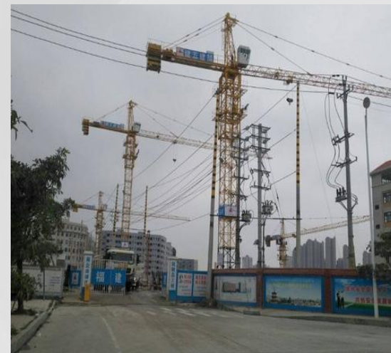
塔吊与外电（高压）架空线路未采取安全措施
