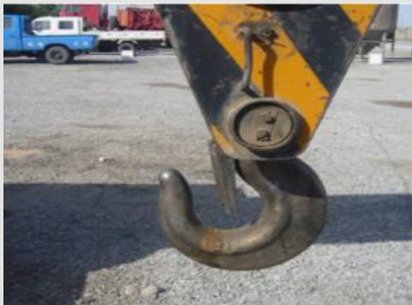
吊钩防脱装置弹簧失效
