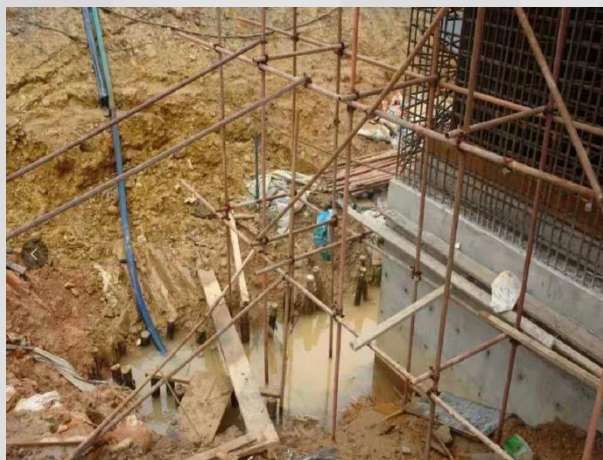
外架支撑立杆底部积水 未进行抽排
