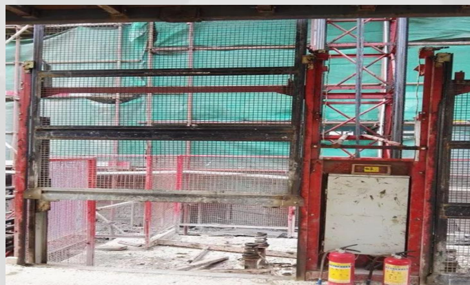
施工升降梯地面围栏门锁失效
