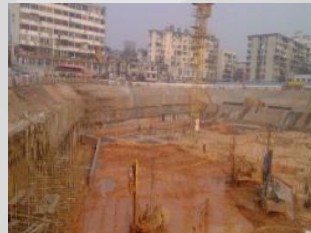
基坑积水未及时抽排
