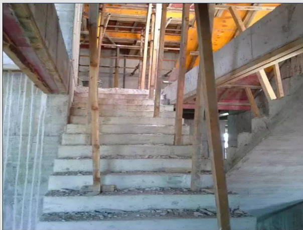
楼梯间支模架钢木混搭且 未设水平杆和扫地杆
