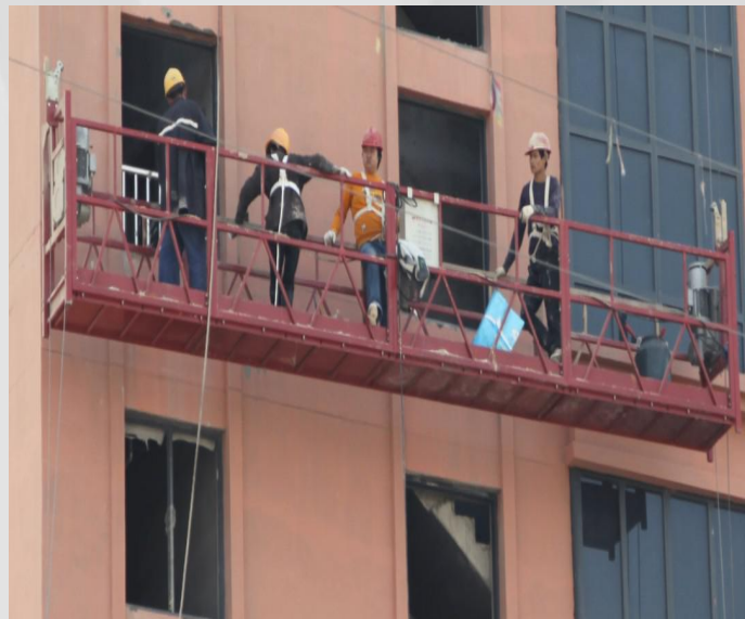
吊篮内作业人员超过2人
