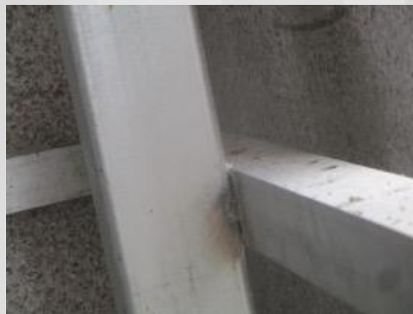
幕墙龙骨焊接部位未涂刷防腐、防锈
