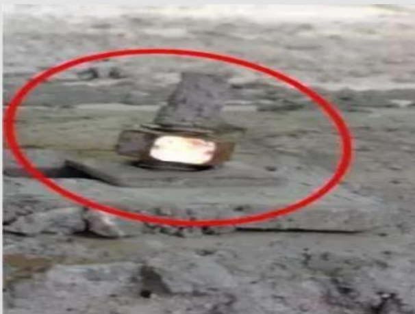
埋板螺栓未拧紧，松动
