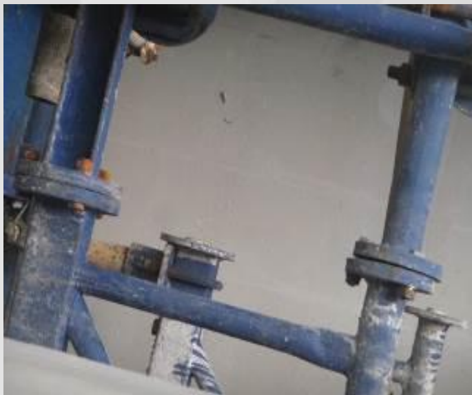
下桁架与主框架连接部位螺栓错位、无拧紧且外露丝扣不足，力矩不足
