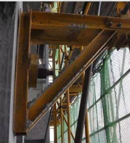
附墙支座歪斜与结构面 存在明显缝隙
