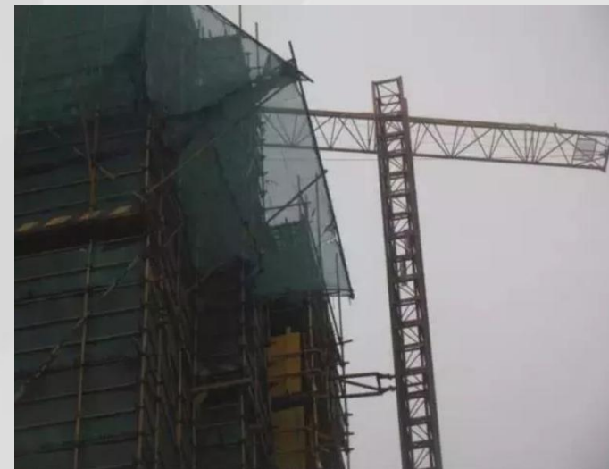
超过说明书最大高度未安装附着装置
