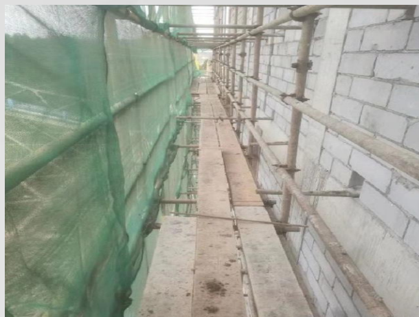
脚手板未满铺
