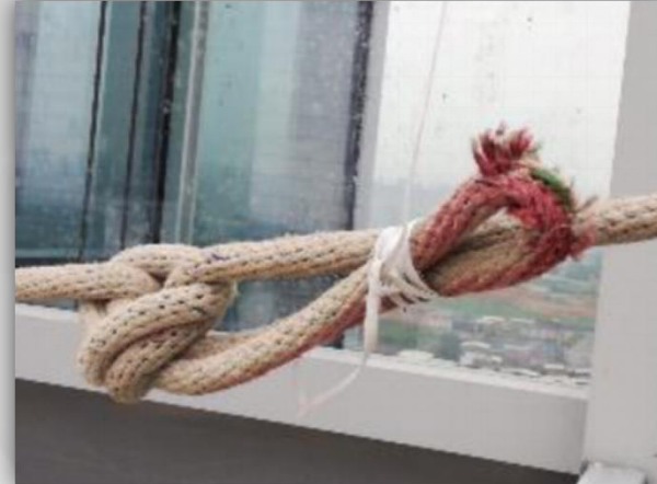
安全绳破损且打结使用
