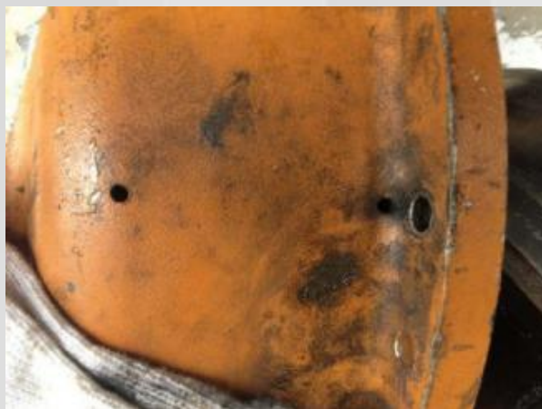
回转构件部位个别固定螺栓缺失
