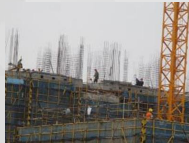
施工层未设1.2m高防护栏杆和18cm高挡脚板
