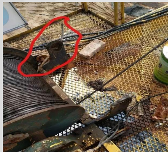
卷筒未安装钢丝绳防脱装置
