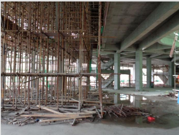
高支模立杆歪斜
