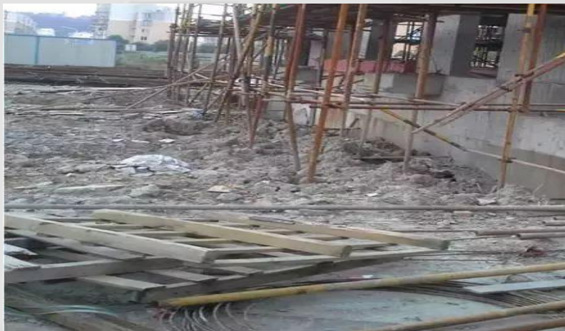
基坑回填土将架体立杆挤压弯曲
