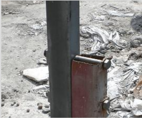
螺栓开孔处存在应力集中
