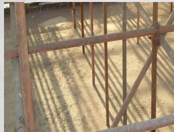
外架支撑立杆底部未设置 5cm高垫块
