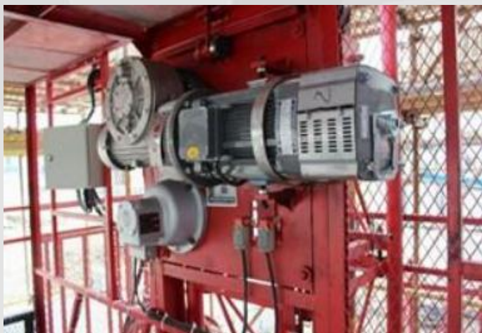
吊笼内未安装起重限制器
