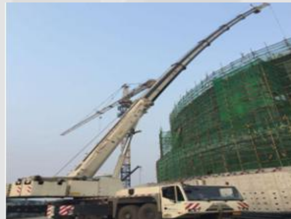
汽车吊作业区域周边无警戒区
