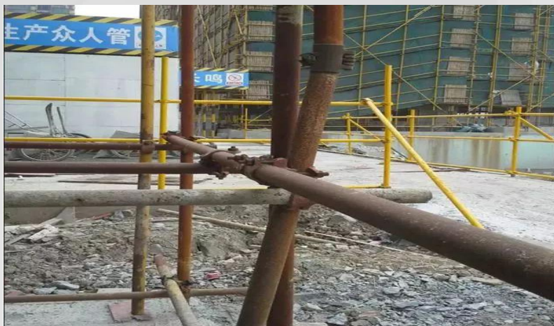
底层立杆因回填土挤压弯曲
