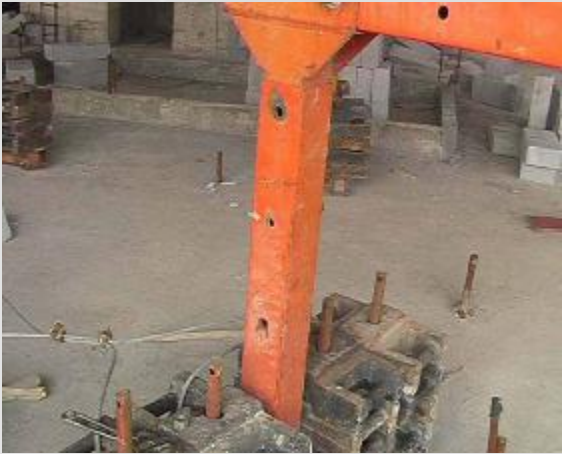
支架固定螺栓螺母缺失
