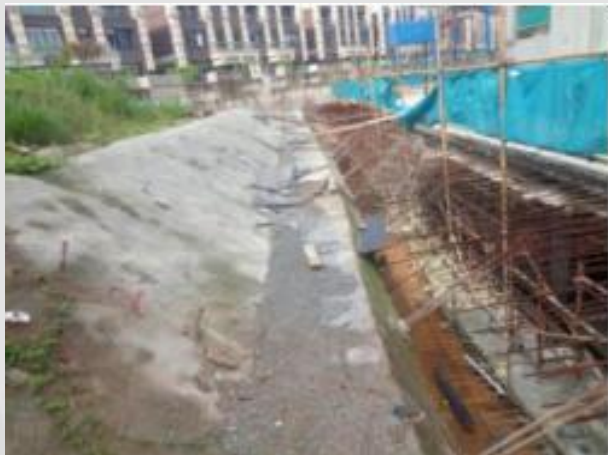
基坑顶部未设置硬性防护
