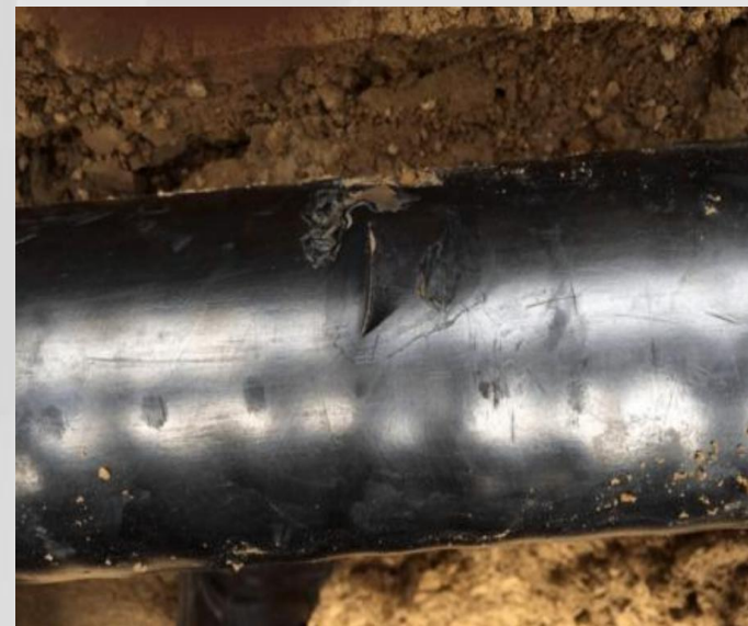
施工升降梯电缆线存在表面明显破损露芯现象
