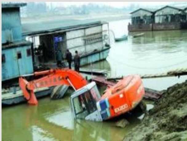
挖机泥软区域作业导致挖机出现滑移
