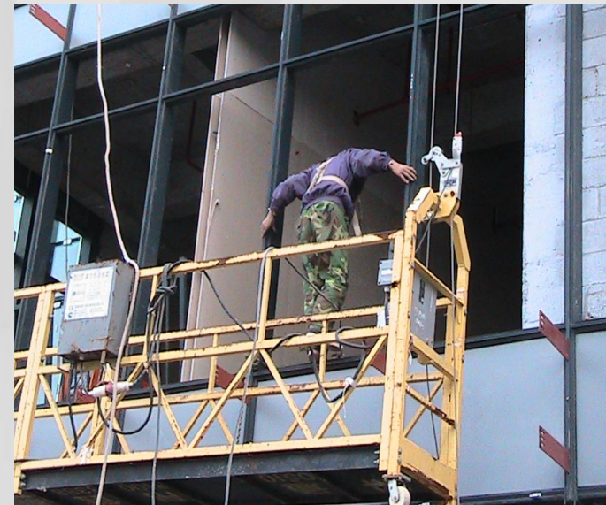
吊篮未落地停放，工人从高空 窗洞口部位进出
