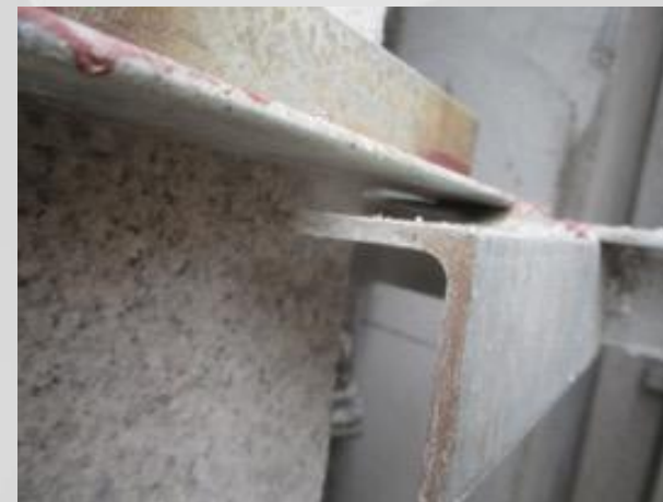
龙骨搭接部位固定螺栓存在漏设现象
