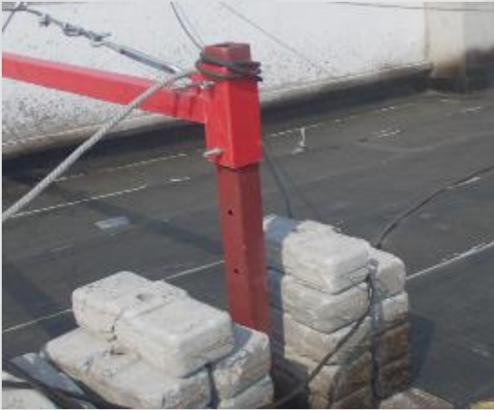
固定螺栓螺母未拧紧
