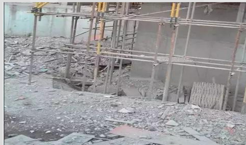
架底基础未硬化，未设扫地杆
