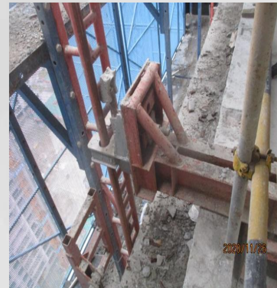
加长部位加固卸荷顶撑 松脱
