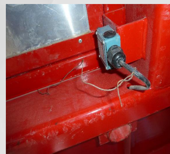
顶窗电器联锁使用铁丝 固定，失效
