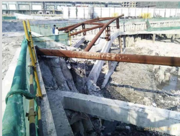
深基坑围护桩存在折断
