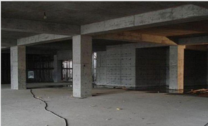
施工升降梯设置在地下室顶板上底部未有回顶等措施
