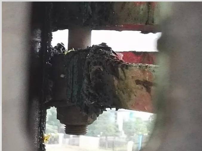
施工升降梯标准节连接螺栓使用单个螺母无垫片，且未紧固 存在手拧松动现象
