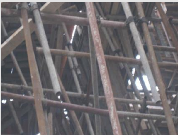
高大支模支撑体系架体立杆多处采用搭接和错位搭接，造成受力杆偏心受力
