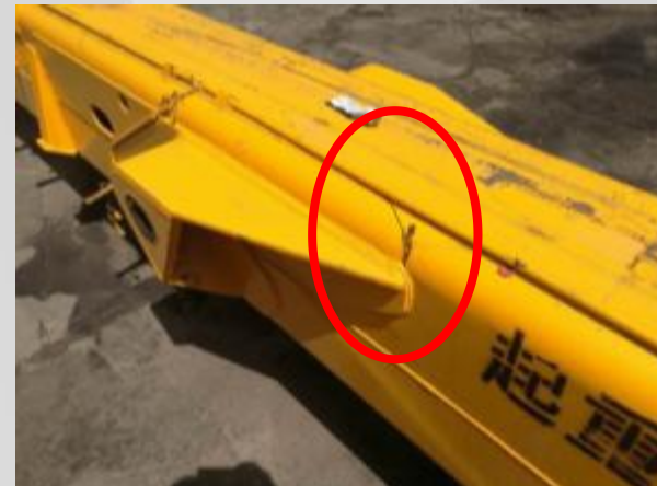
起升吊臂出现明显裂纹、锈蚀
