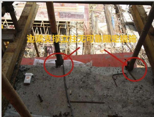
边梁支撑立杆无可靠固定措施
