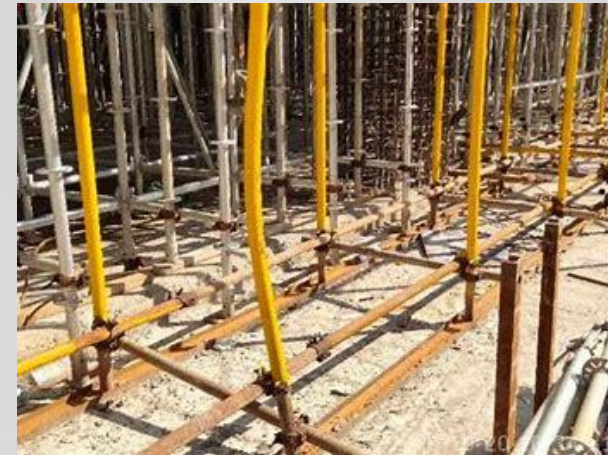
脚手架立杆弯曲变形
