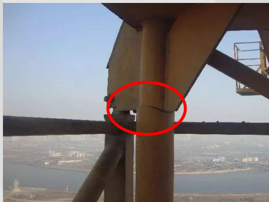
主弦构件存在断裂现象
