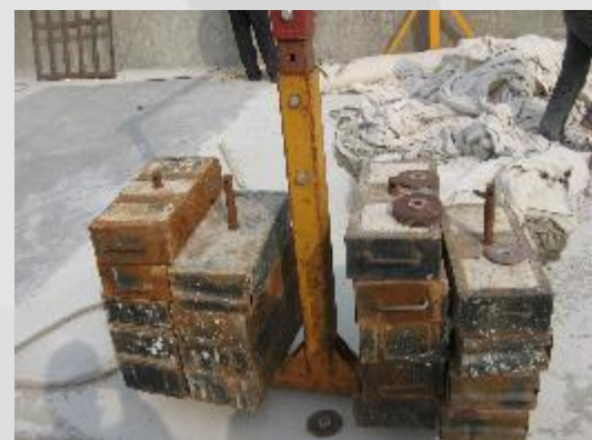
配重块未固定
