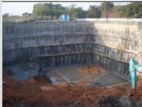
深基坑人员上下无专用通道
