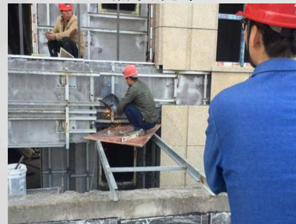
幕墙动火作业施工时未设置接火盒或挡火盒等防火措施
