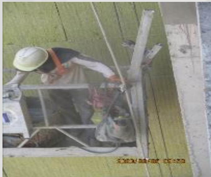
吊篮内作业人员未挂设安全 带
