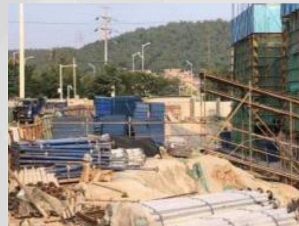
基坑顶部 2 米安全 范围内堆放施工材料
