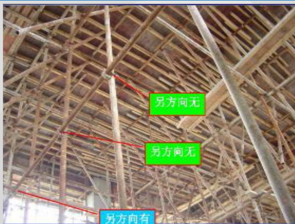
架体中每隔多根立杆设置一道双向水平杆，造成横、纵向水平杆强度和刚度达不到实际验算要求
